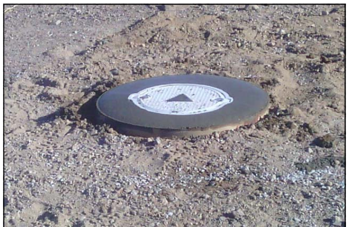
Una boca de pozo monitoreo típico
