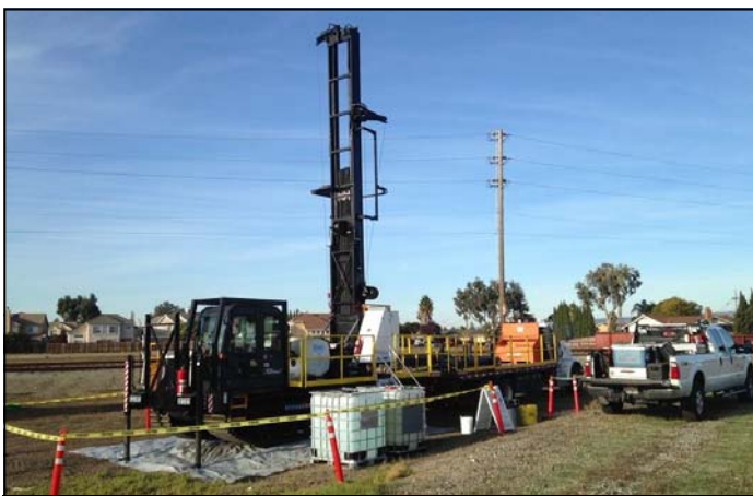
La plataforma de perforación típica, la cual será utilizada
