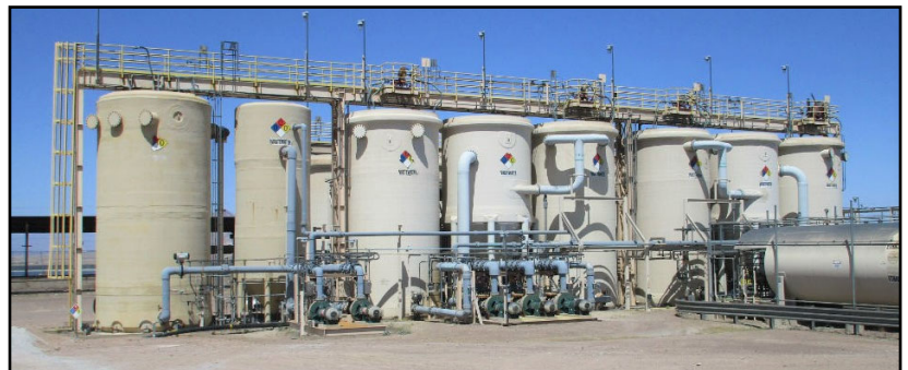
Sistema de Tratamiento de Aguas Subterráneas del Sitio NERT
