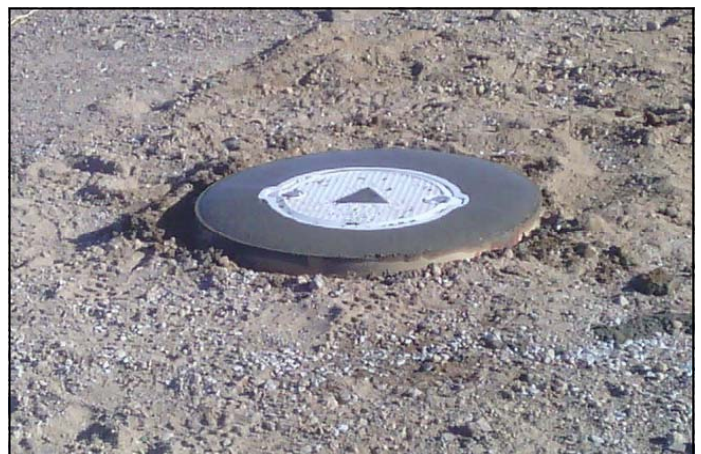
Una boca de pozo monitoreo típico
